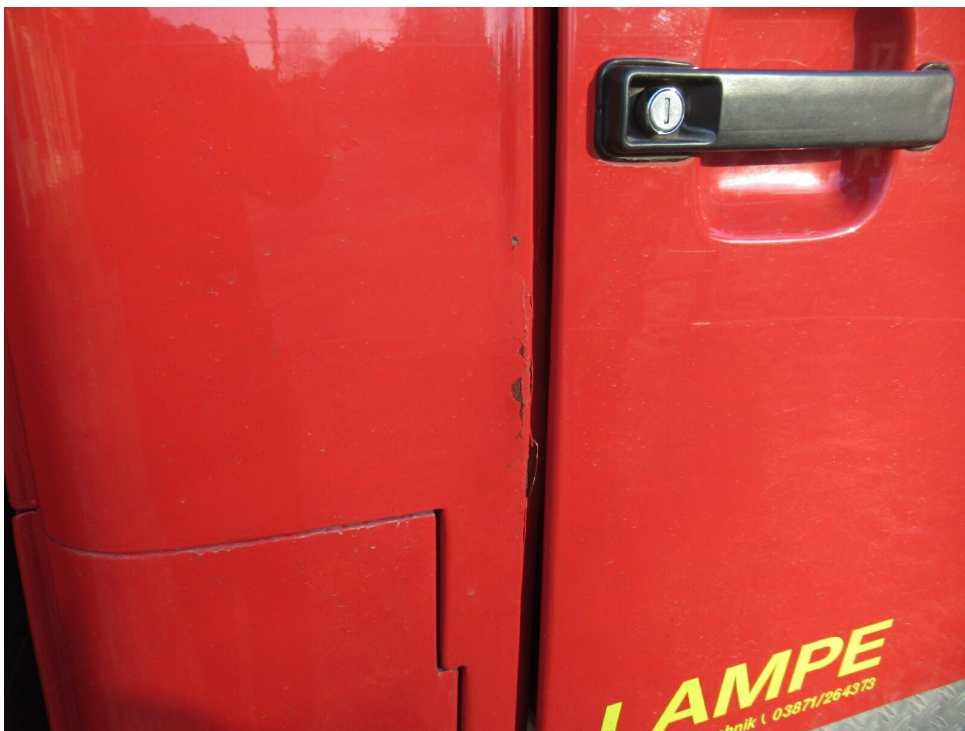
Bild 45 : Schadenübersicht Fahrerhaus unterhalb
