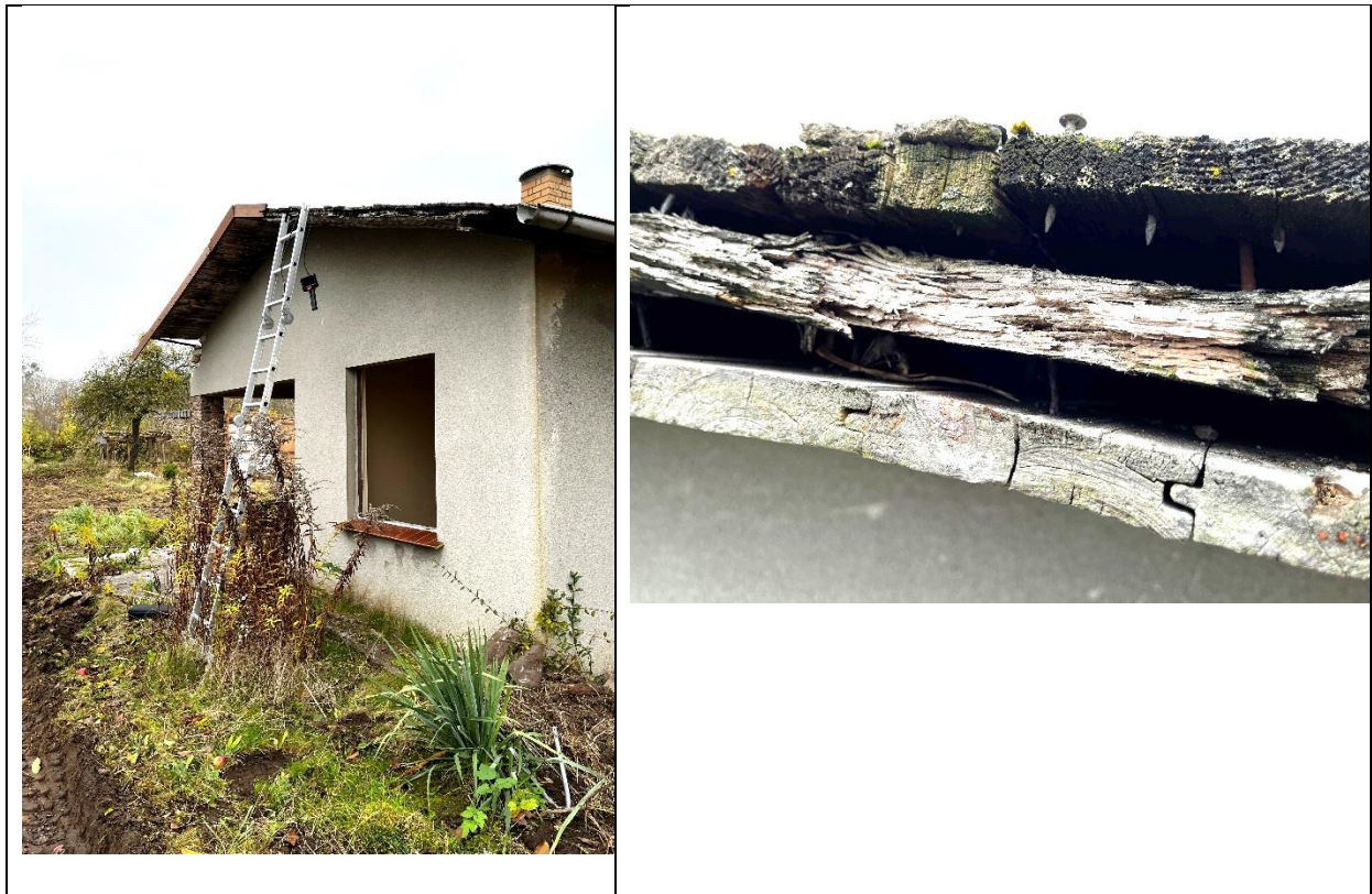
Abbildung 4: Gartenlaube, wo sich die obere Dachschiene nicht so entfernen ließ, dass nicht die gesamte Dachkonstruktion zerstört worden wäre, PfaU GmbH 12.11.24
